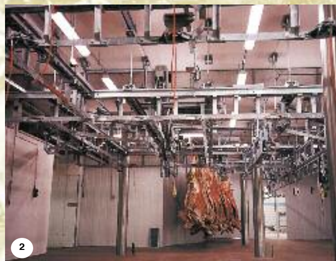
2 Impianto con colonne di sostegno in acciaio inox
