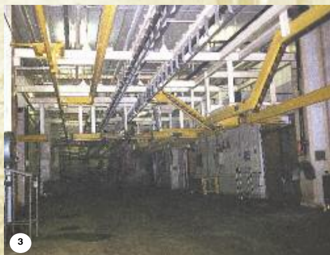
3 Impianto munito di coclee per abbassamento monorotaia
