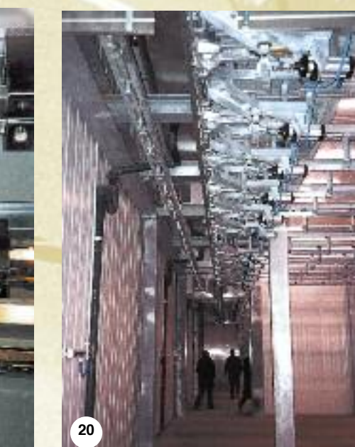
20 Testata con diramazioni nelle celle carni
