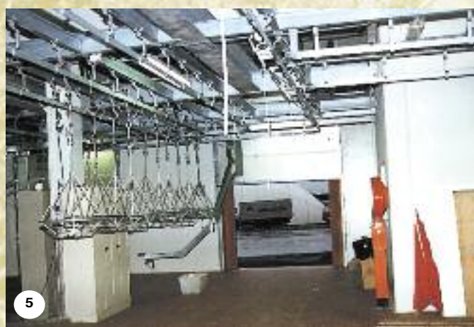
5 Bocca di carico dotata di braccio articolato elettroidraulico per lo scarico delle carni
